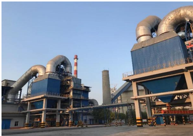
槐坎南方水泥1# 熟料生产线脱硫脱硝综合治理
