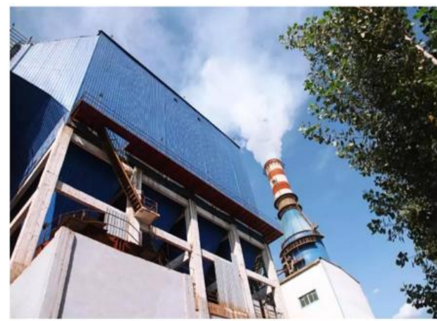
唐山建龙烧结机烟气脱硫脱硝一体化
