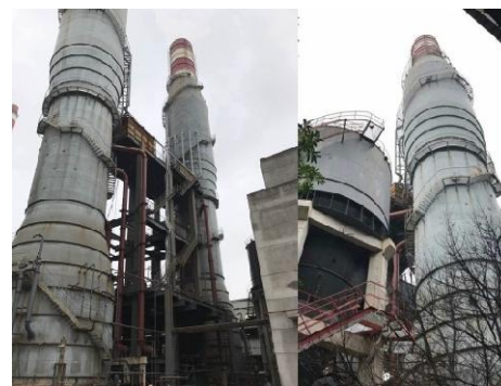
江南化纤集团热电厂锅炉烟气脱硝脱硫一体塔
