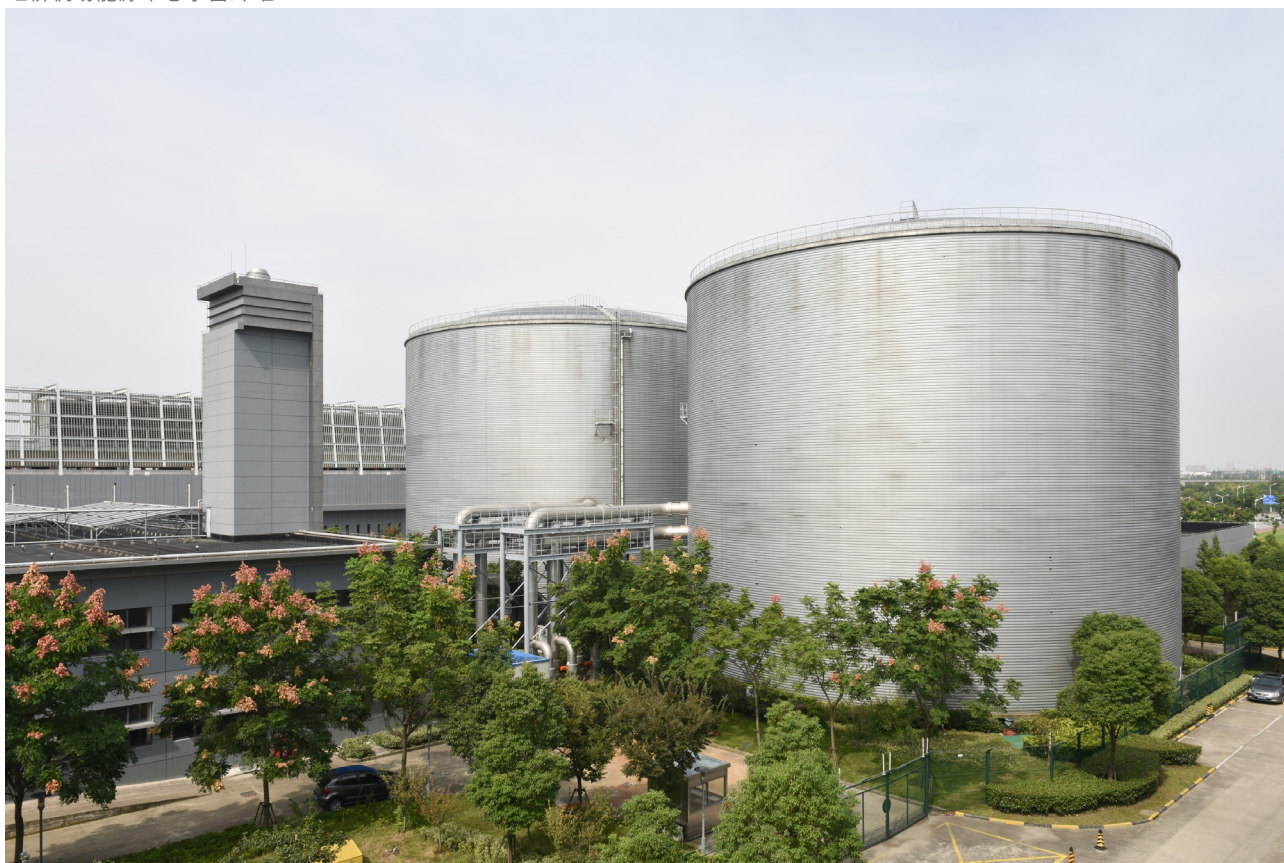
虹桥机场能源中心水蓄冷罐
